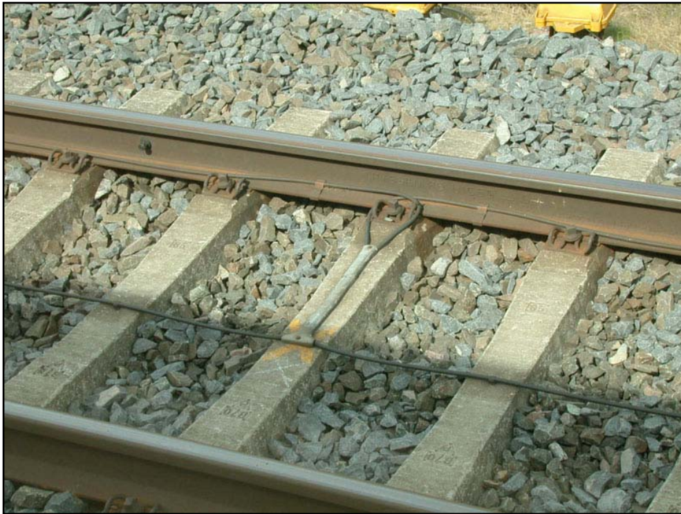
Obr.1 – kabel LZB s křížením žil
